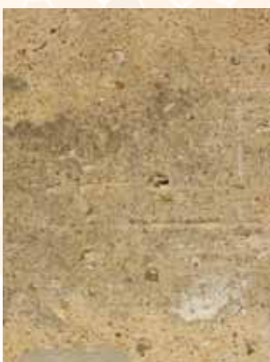
Montcorbon - Enduit réalisé à partir de sable limono-argileux extrait en Gâtinais et localement appelé sable à lapin. © CDL
