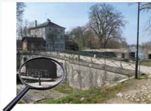
Châtillon-sur-Loire – Écluse de Mantelot, site étudié lors de l'inventaire patrimonial des canaux du Loiret. © CDL
