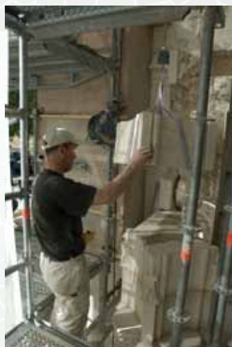
La pierre taillée est levée grâce à un treuil puis déposée à l'emplacement prévu. © ADL, L'Volland
