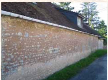
Aulnay-la-Rivière - Mur enduit de ciment de tuileau. © CDL
